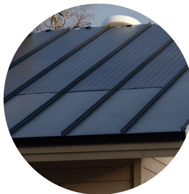
Aurinkopaneelit integroituna kattopaneeleihin (VirteSolar)
